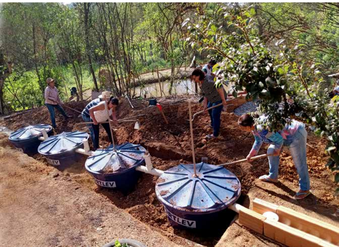
Construção de fossa séptica biodigestora na propriedade da Jandira do Carmo, em Bonfim. Foto: Anna Salles
